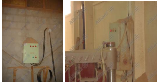
Bakımsız elektrik tesisatı -1-
