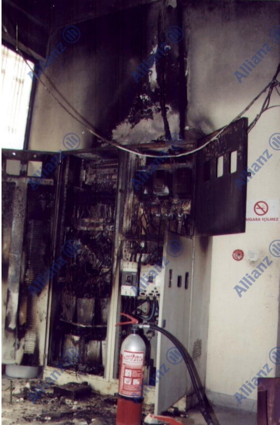
Resim 1 – Aşırı ısınma sonucu yangına sebebiyet veren elektrik panosu
