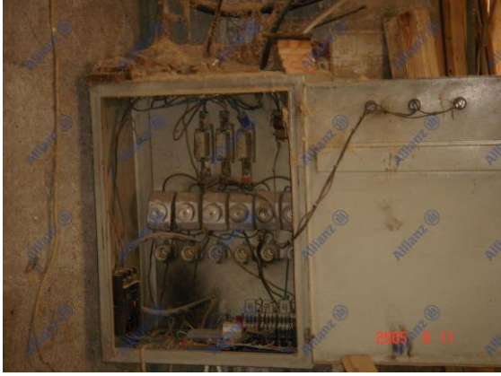
Resim 2 – Elektrik panosu üzerinde birikmiş ahşap tozları ve düzensiz elektrik tesisatı
