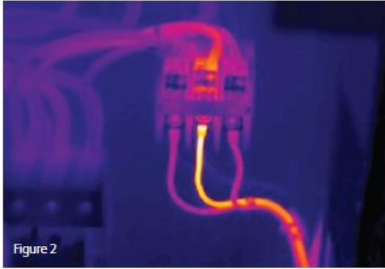
Termal Kamera (Isınan Kablo)
