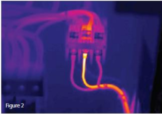
Termal Kamera (Isınan Kablo)
