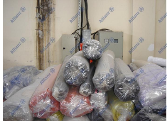
Resim 6 - Elektrik panosu önünde yapılan kumaş depolaması.
