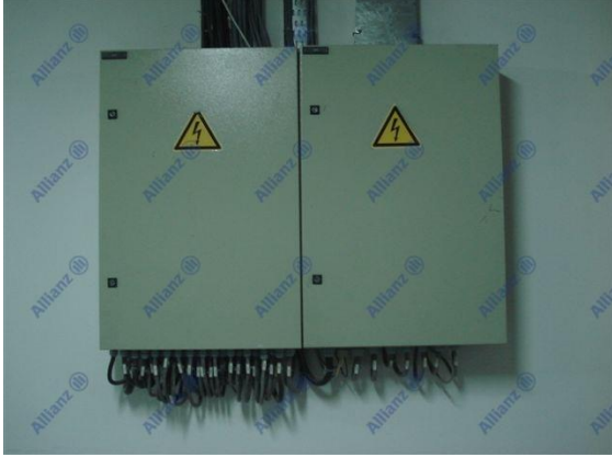
Resim 5 - Etanj özellikteki elektrik panosu. Kablo girişlerinde uygun rekorlar kullanılmış ve bağlantılar düzgün bir biçimde yapılmıştır.
