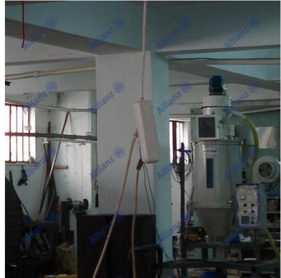
Resim 7 - Uygun olmayan seyyar kablo bağlantıları.
