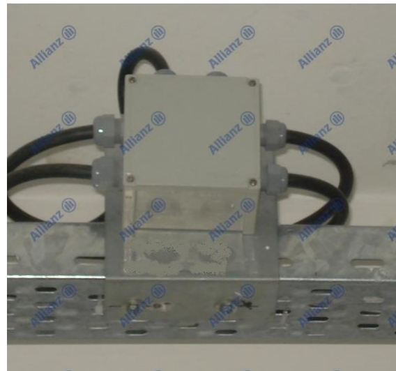
Resim 4 – Etanj buat. Kablo girişlerinde uygun rekorlar kullanılmış ve tesisat dış ortamdan yalıtılmış.
